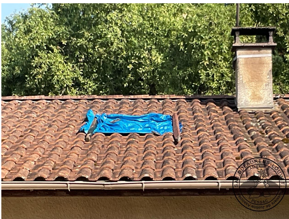
Bâche temporaire en toiture
