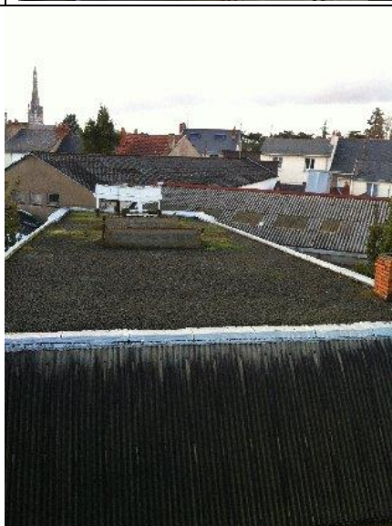
Photo n° Ph001 Localisation : réception marchandises Ouvrage : Toiture, terrasse et étanchéité - Plaques ondulées et planes Partie d'ouvrage : Plaques en fibres-ciment Description : Plaques en fibres-ciment
